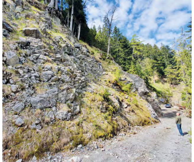
Eine instabile Felsböschung gefährdet den Forstweg.
