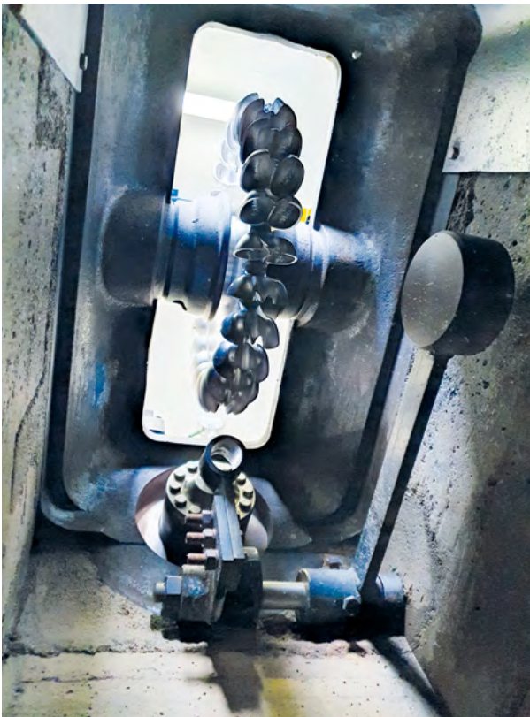
Das Turbinenlaufrad unseres Trinkwasserkraftwerks Latz Oberstufe
