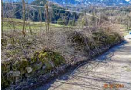
Starker Bewuchs sprengte das alte Mauerwerk.
